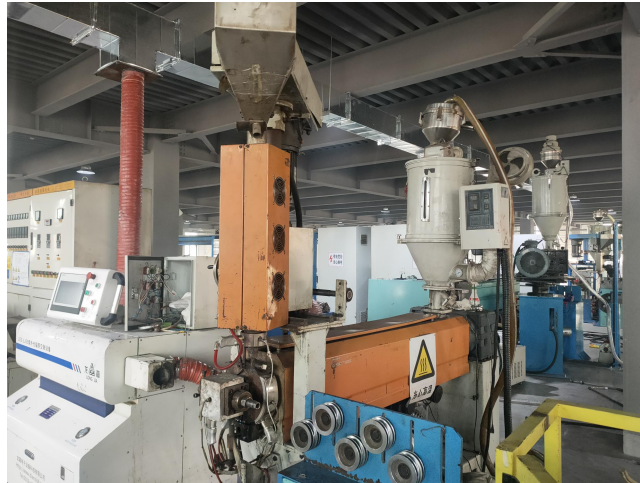
挤出机头部配套集气管道
