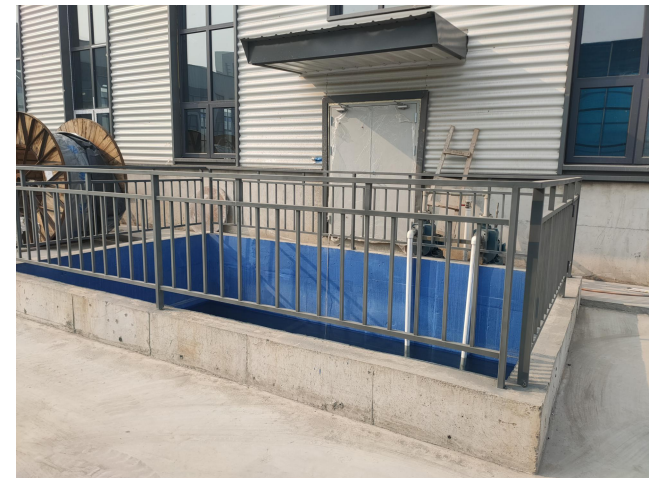
冷却水收集循环水池
